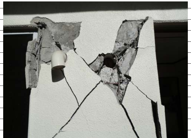
・非構造壁のせん断破壊(拡大)
