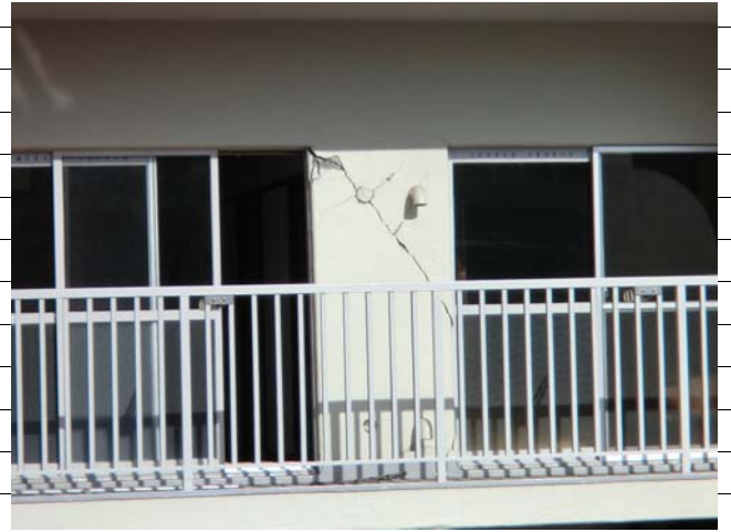
・非構造壁のせん断破壊
