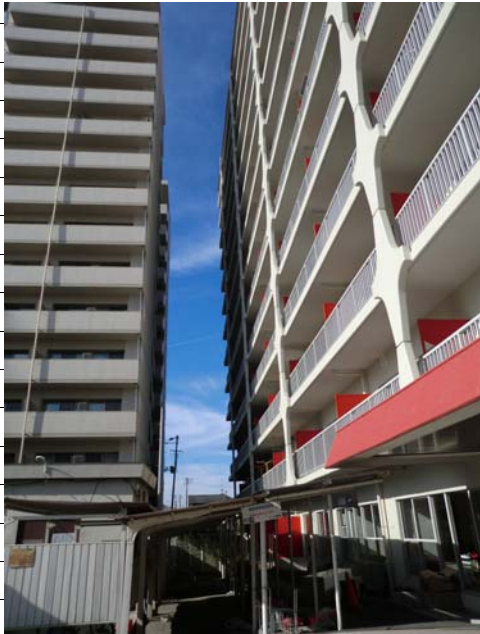
・写真右の建物が左に傾斜している
